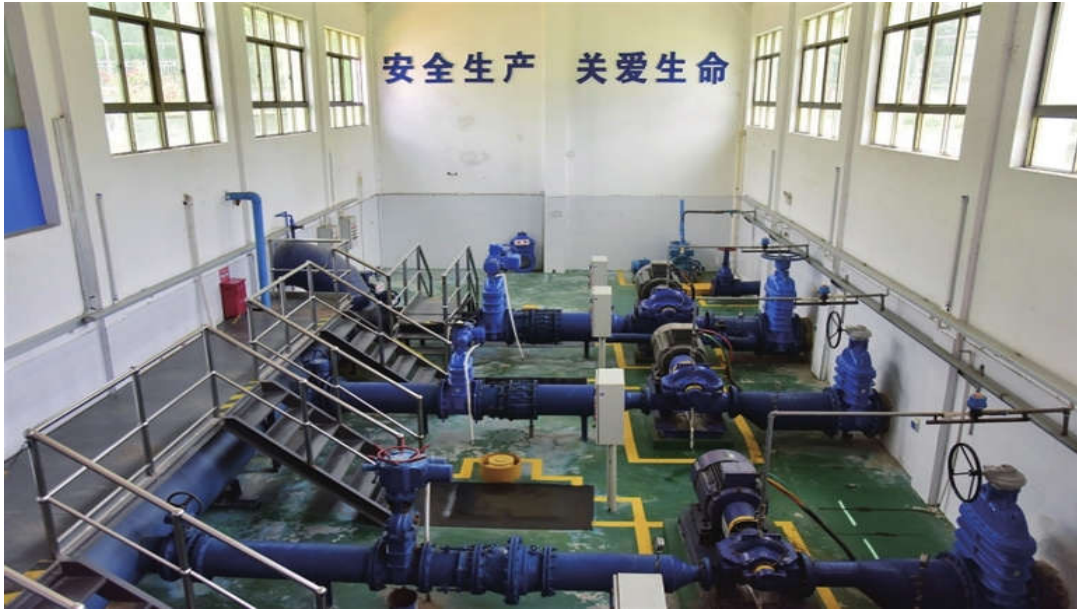
荔枝沟水厂的水泵机。
